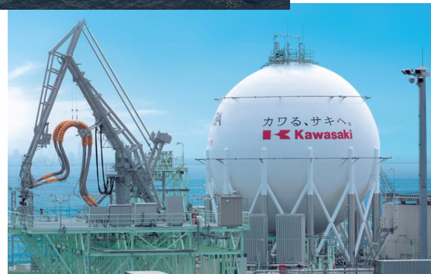
液化水素 貯蔵タンク
